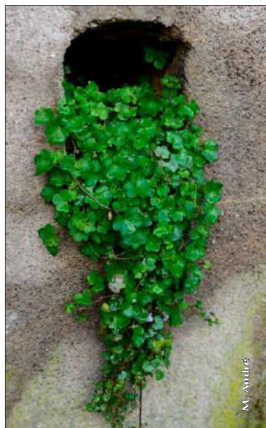
Figure 3 : Cymbalaria muralis dans le drain d'un mur bétonné.
